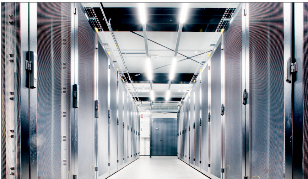
Kaltgang Rechenzentrum Appenweier Quelle: E-Werk Mittelbaden
